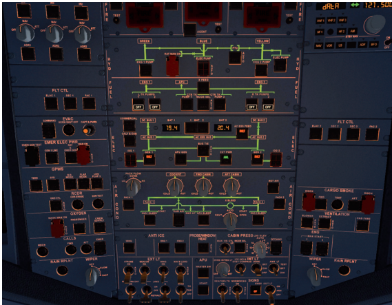
Panneau supérieur avant la coupure OFF des batteries
